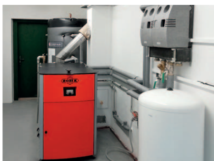
Vzorová kotelna s kotlem ROJEK PK BIO 40
